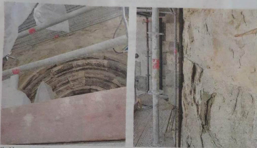
L'evidente stato di degrado della pietra arenaria nella facciata del transetto sud del Duomo
